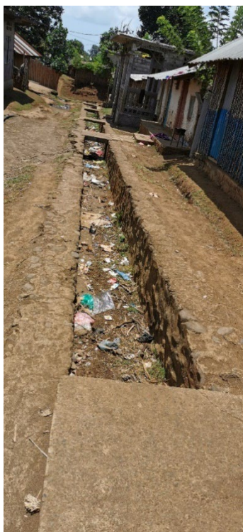
Fig. Canneau de drainage dans le quartier Kanaleni
